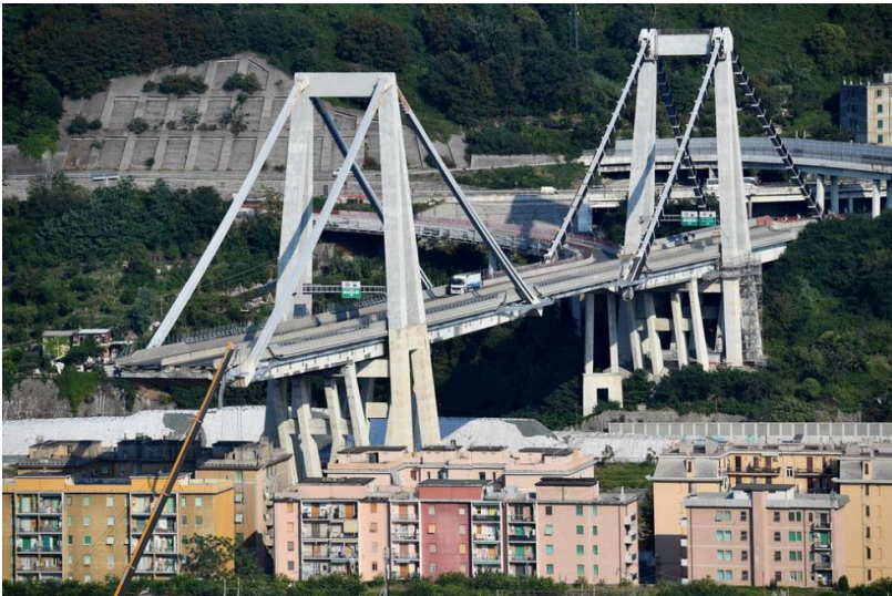
Fig. 2 – Overblijvend deel van de Morandibrug na de instorting van het centrale deel
